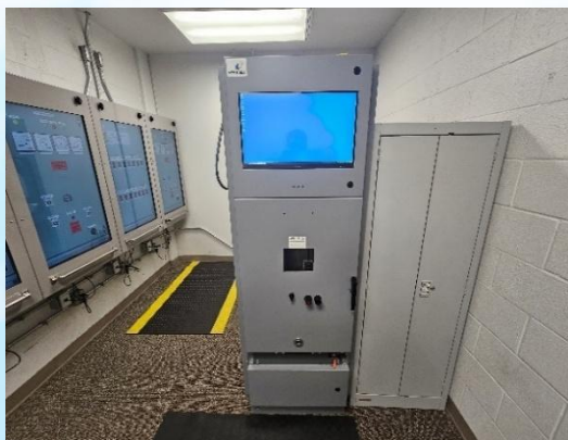
Figure 7. HV ERS 2 FMS HV Breaker
